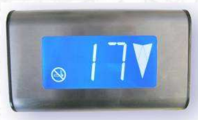
kaseta sygnalizacji dojazdu i położenia
